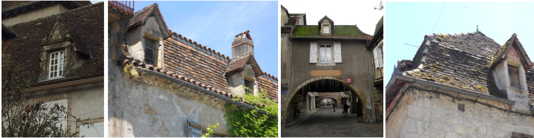
Exemples de lucarnes en pierre à fronton. A noter le premier exemple particulièrement remarquable de lucarne à fronton mouluré du XVIIIème siècle. Dans le dernier exemple, la lucarne est dite passante car elle interrompt l'égout de la toiture.
