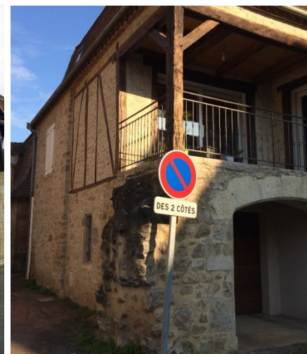
Arrachement de la porte Ouest
